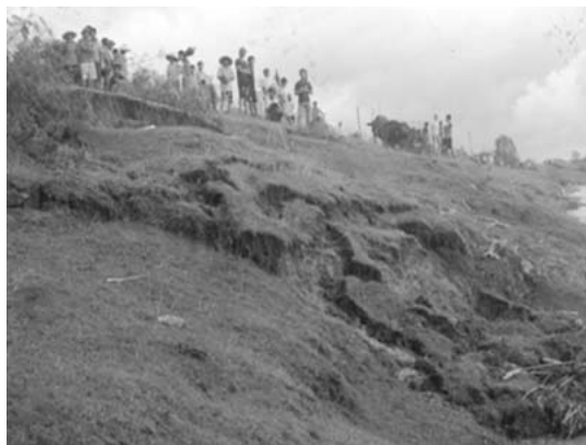
Hình 1: Sạt lở mái đê tả sông Chu tại xã Thiệu Vũ năm 2012
