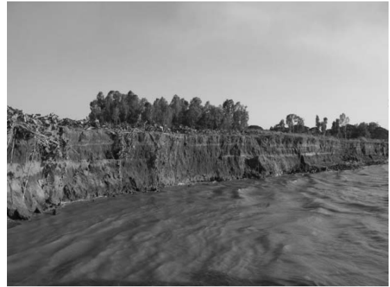
Hình 3. Sạt lở bờ phía cù lao Long Khánh 8/2012
