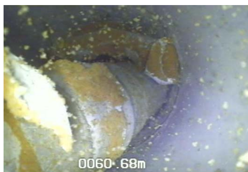
Hình 10. Ống chống đường kính 250mm bị đâm thủng [5]
