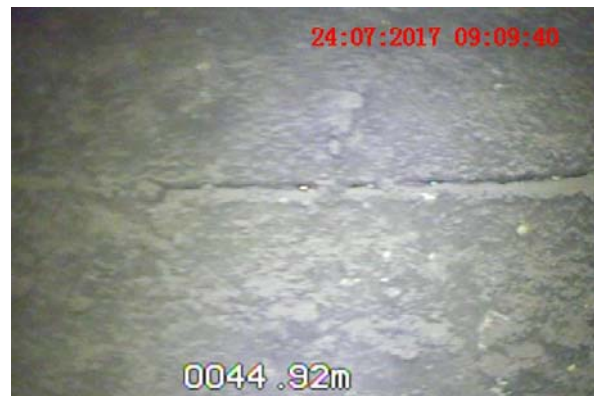
Hình 7. Vết thủng tại mối hàn nối ống tại độ sâu 44,92m [5]
