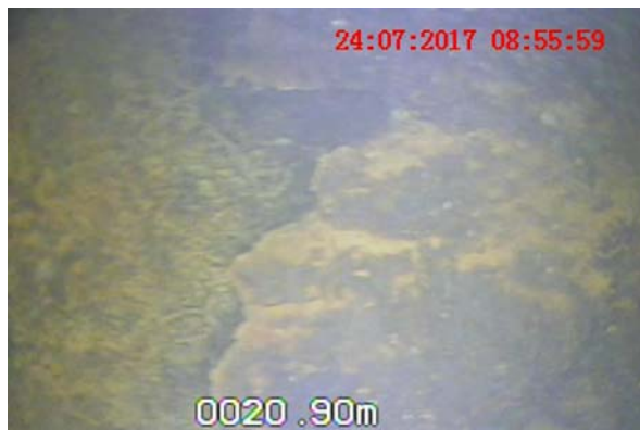
Hình 6. Vết nứt tại độ sâu 20,90m [5]
