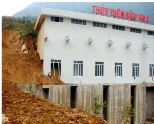
Hình 3: Thủy điện Sử Pán 2 bị sạt lở đất
