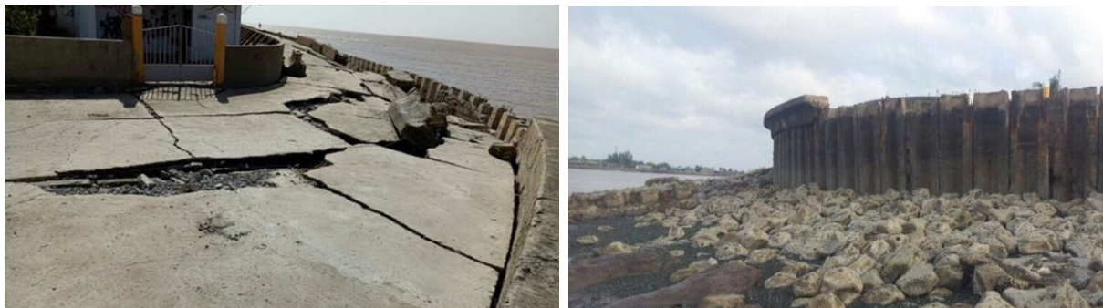
Hình 3: Hình ảnh sự cố kè Gành Hào đoạn G1-835m, ảnh chụp tháng 02/2017
