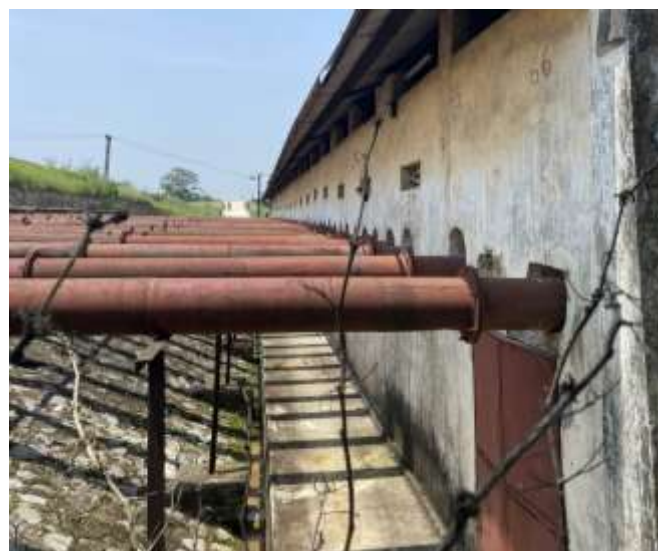
Hình 7: Trạm bơm Tân Chi 1
