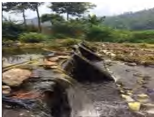
Hình 22: Hiện trạng công trình đập Phai Vọng
