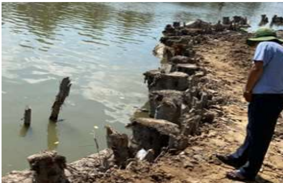
Hình 4: Hiện trạng giải pháp bảo vệ bờ tại bờ sông Cầu Ngang
