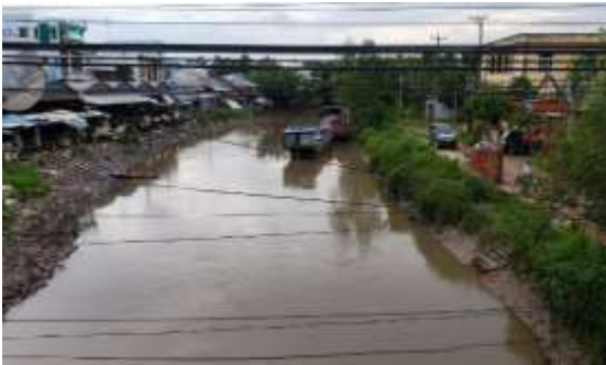
Hình 2: Toàn cảnh hiện trạng sạt lở bờ sông Cầu Ngang
