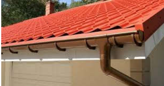
Hình 1. Máng thu nước mưa trên mái nhà
