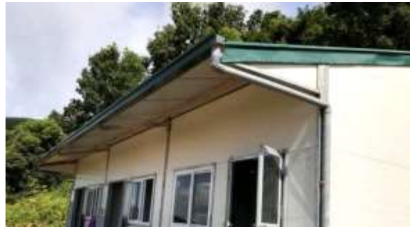
Hình 4: Máng thu nước mưa trên mái nhà
