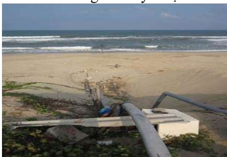
Hình 7: Trạm bơm đặt trong bờ hút nước trực tiếp từ ống lọc chôn ngầm dưới biển
