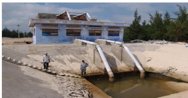
Hình 16: Trạm bơm, bể hút đặt sát chân đê
