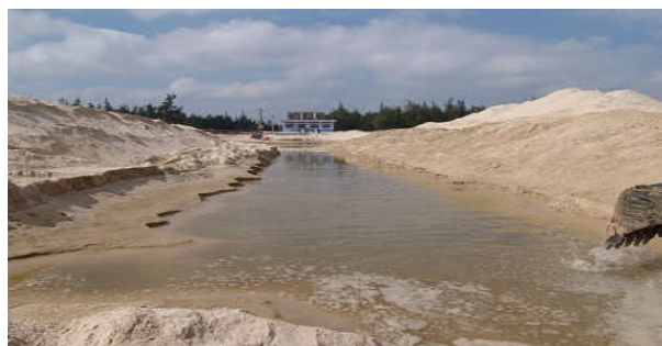
Hình 17: Kênh dẫn nước biển vào bể hút
