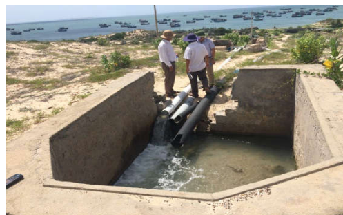
Hình 8: Hình thức lấy nước bằng ống lọc và ống hút chôn ngầm dưới đáy biển kết hợp với cửa thu nước trong bờ
