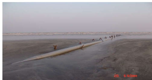
Hình 19: Đường ống dẫn nước vào bể hút
