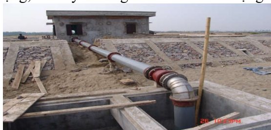
Hình 18: Bể hút trạm bơm đặt sát chân đê
