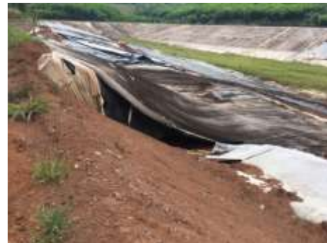
Hình 2: Hư hỏng mái hồ bùn đỏ
