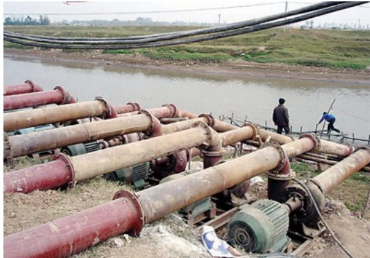
Hình 4. Trạm bơm đã chiến xã Xuân Phú trên sông Hồng (năm 2002)
