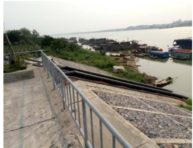
Hình 3. Trạm bơm Cửa Đình (Gia Lâm)
