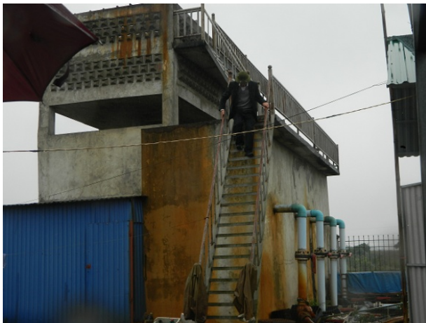
Hình 8. Trạm khai thác nước ngầm xã Thụy Hương (bãi sông Đáy)
