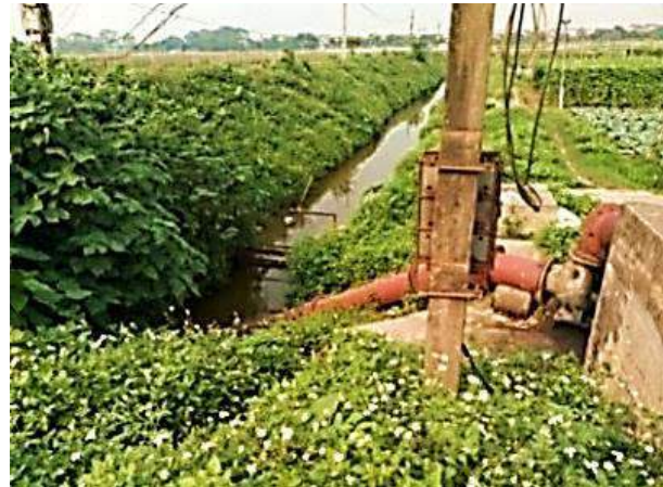
Hình 2: Trạm bơm dã chiến xã Văn Đức
