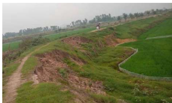
Hình 1: Đê bồi Nguyễn Huệ bị sạt lở nghiêm trọng do lũ lụt tháng 09/2024
