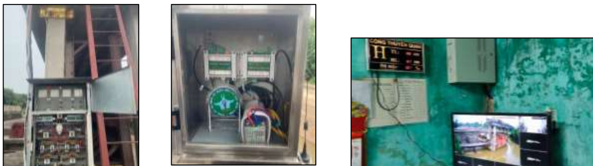
Hình 4: Thiết bị ngoại vi lắp đặt tại cống Thuyền Quan
