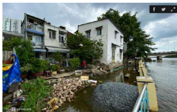
b. Sạt lở, sụp đổ đoạn bờ kè kênh Thanh Đa, TP Hồ Chí Minh (Kè tường đứng kết hợp mái nghiêng)
