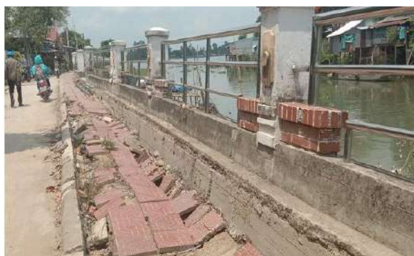
a. Sạt lở đoạn bờ kè sông Tiền khu vực chợ Bình Thành, tỉnh Đồng Tháp (Kè mái nghiêng)
