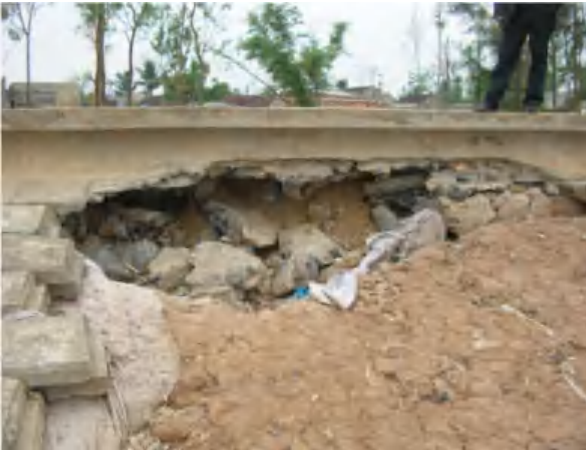
Hình 2: Mái kè hư hỏng dưới tác động của sóng
