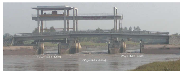
Hình 7: Công hở ĐBSCL đã mở thêm khoang công (cửa van mở cưỡng bức) ở 2 bên mang công đã có
