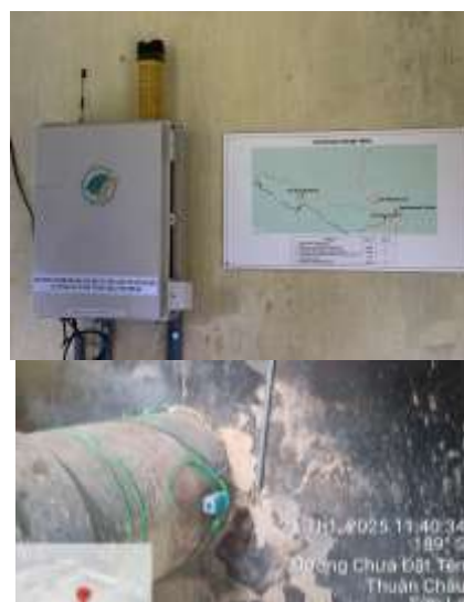
(c) Trạm đo lưu lượng đường ống
