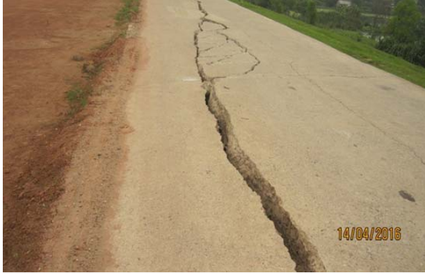
Hình 1. Nứt vỡ mặt đê Tiên giang, huyện Yên Dũng – Bắc Giang
