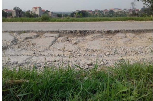
Hình 2. Nứt vỡ mặt đê Hữu đuông km21+600÷km59+600 – Bắc Ninh
