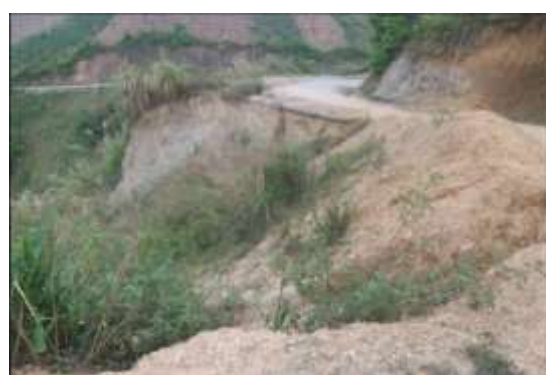
Hình 14: Trượt lở mái ta luy âm đường xã Mường Trai, tỉnh Sơn La
