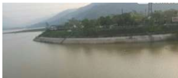
Hình 13: Xử lý mái dốc bán ngập tại thị xã Mường Lay tỉnh Điện Biên
