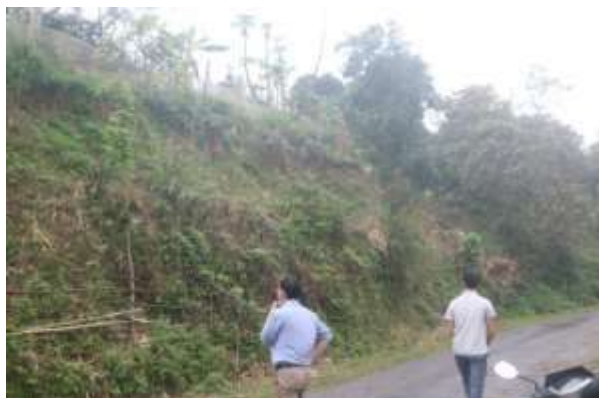
Hình 11: Trượt lở mái dốc đường nội bộ xã Lê Lợi, huyện Nậm Nhùn
