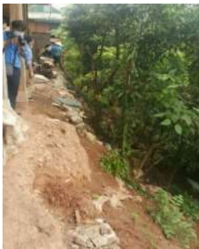
Hình 16: Biện pháp xử lý tạm đối với trượt lở tại thôn Huồi Trắng, Điện Biên
