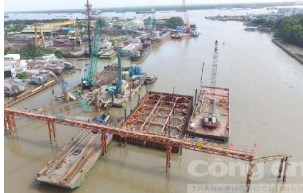
Hình 4: Thi công đập trụ đỡ bằng khung vây cọc ván thép 1 lớp
