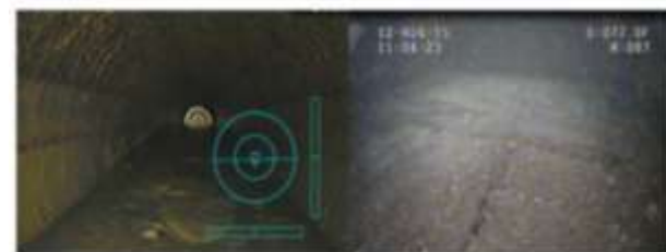
Hình 11: Phát hiện vết nứt bê tông tại dự án Lower Baker
