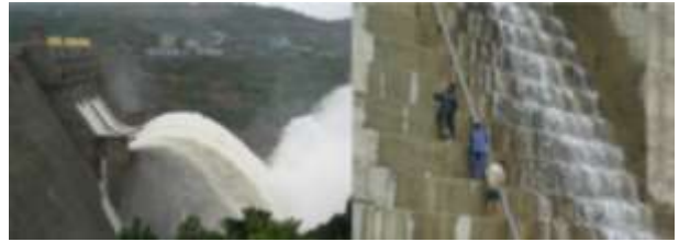
Hình 3: Hiện tượng nứt, rò rỉ nước tại bờ đập Sông Tranh 2
