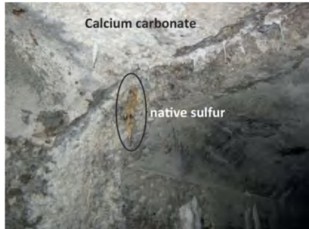
Hình 3: Carbonate hóa và ăn mòn sun phát của tường bê tông sát với lớp đá địa chất
