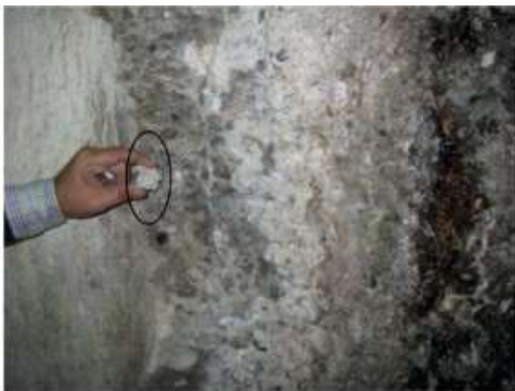
Hình 4: Các mảng bê tông bị mất tính chất cơ học, bị tách rời ra khỏi công trình do thaumasite
