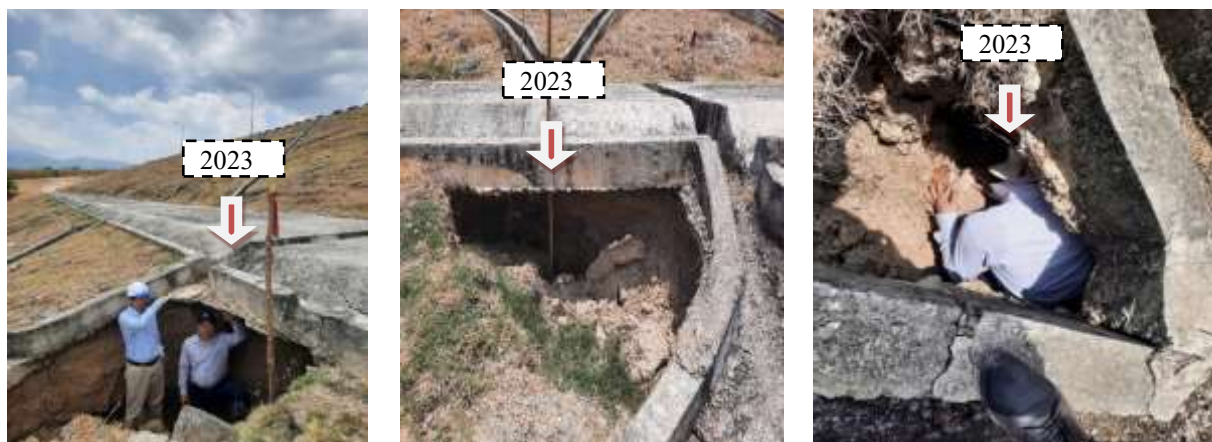
Hình 3: Hình ảnh các hố sụt tại mái hạ lưu đập năm 2020-2023
