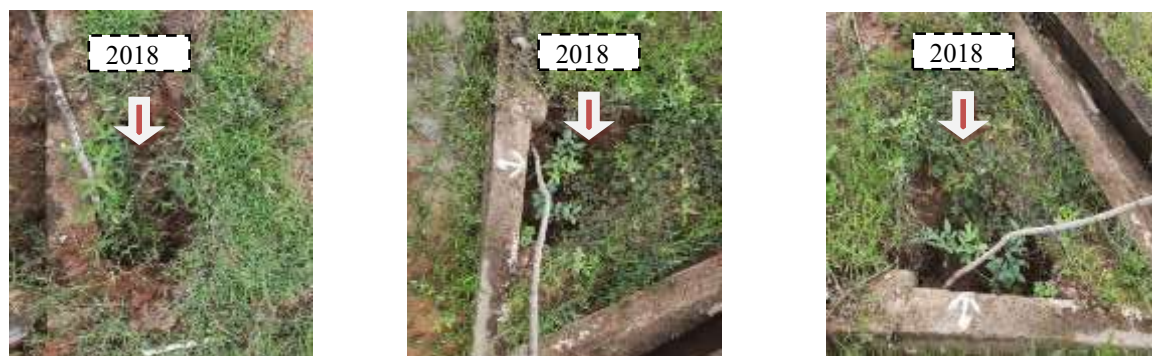
Hình 2: Hình ảnh các hồ sụt tại mái hạ lưu đập năm 2018-2020
