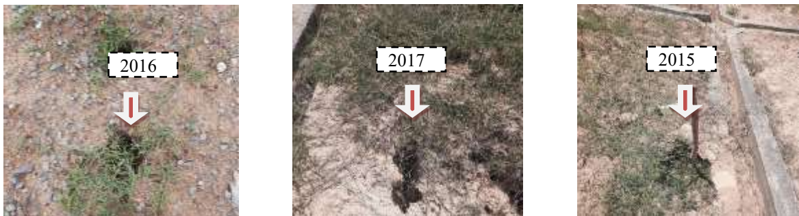
Hình 1: Hình ảnh các hồ sụt tại mái hạ lưu đập năm 2014-2017
