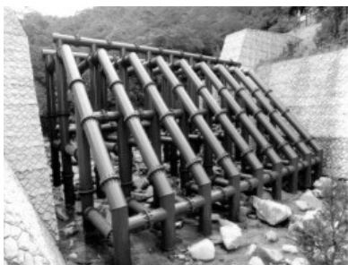
a) Đập hở cấu trúc thép Ống tại sông Ashiya, Nhật Bản.
