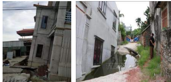
Hình 4: Hố sụt do xây dựng nhà tại Mỹ Đức
