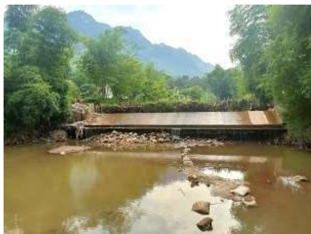
Hình 2.5: Sân tiêu năng sau đập dâng xã Mường Bú (Mường La, Sơn La) bị cuốn trôi hoàn toàn
