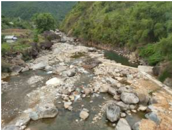
Hình 2.1: Đập dâng bê tông thuộc công trình Thủy lợi C23 (Pắc Ta, Lai Châu) bị cuốn trôi hoàn toàn
