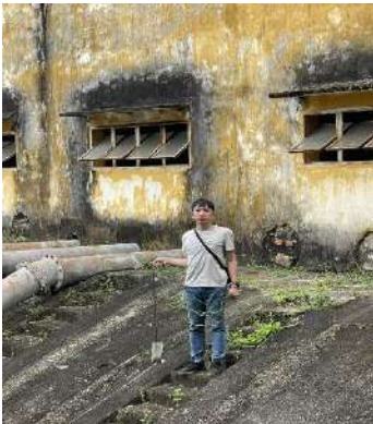
Hình 4. Trạm bơm Bích Bắc
