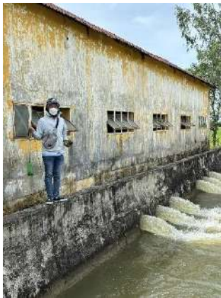
Hình 4. Trạm bơm Bích Bắc
