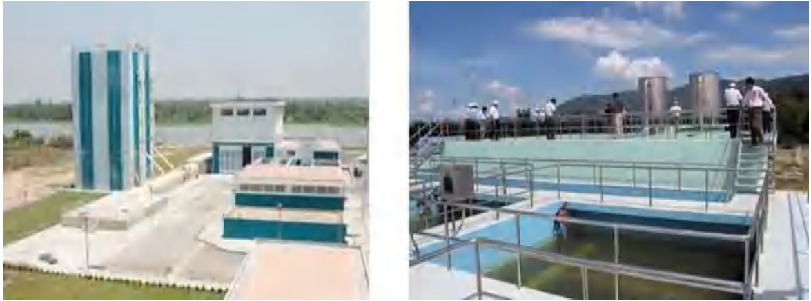
Hình 2.9: Trạm bơm Hòa Phú trên sông Sài Gòn
