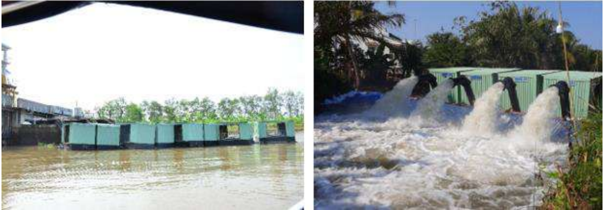
Hình 4-6: Trạm bơm nổi, di động Xuân Hòa, tỉnh Tiền Giang
