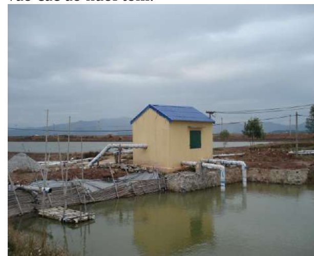
Hình 4: Trạm bơm cấp nước cho hệ thống các ao nuôi tôm tại Tân An.
