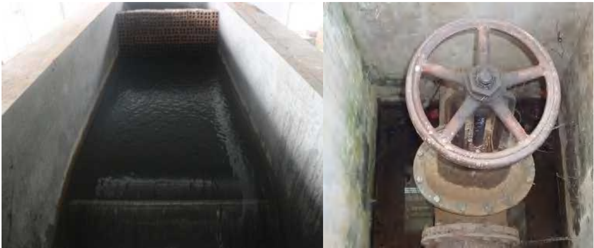
Hình 2.18. Thiết bị đo lưu lượng và van chỉnh nước (Nguồn: Thiết bị Phòng thí nghiệm Viện KHTLMN)
