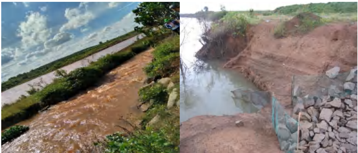
Hình 3.9. Đoạn kênh đất lót đá cuội bị xạt lở hai bờ (bên trái, tháng 7/2018) và cửa vào/ra phía hạ lưu ĐDCQĐ (bên phải, tháng 03/2018)
