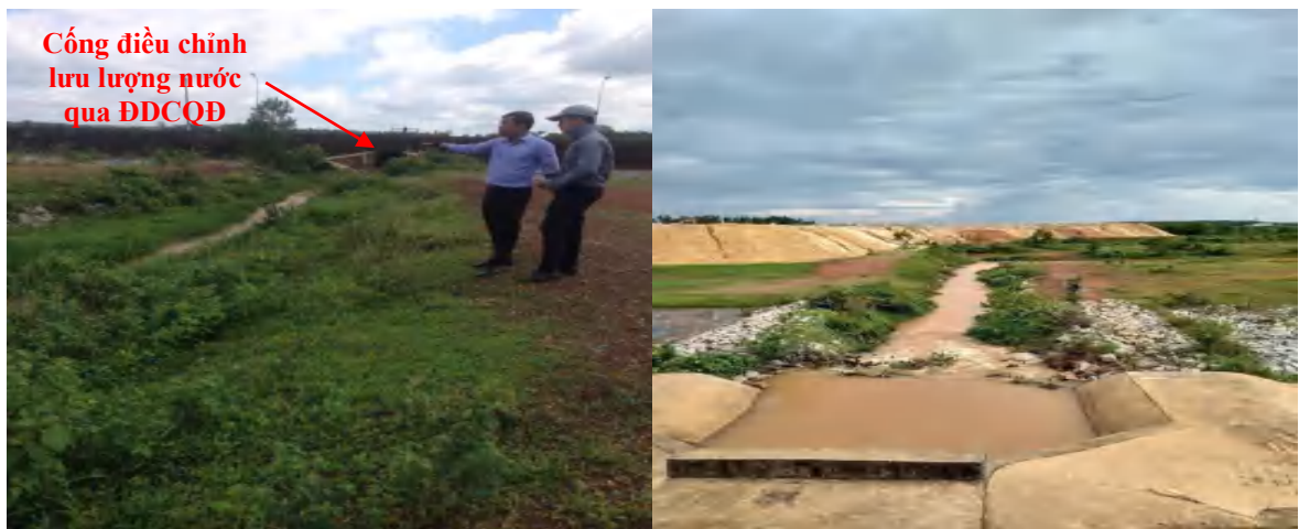
Hình 2.3. Đoạn kênh phía trước (bên trái; tháng 3/2018) và phía sau (bên phải; tháng 7/2017) cống điều chỉnh lưu lượng nước qua ĐDCQĐ Phước Hòa
