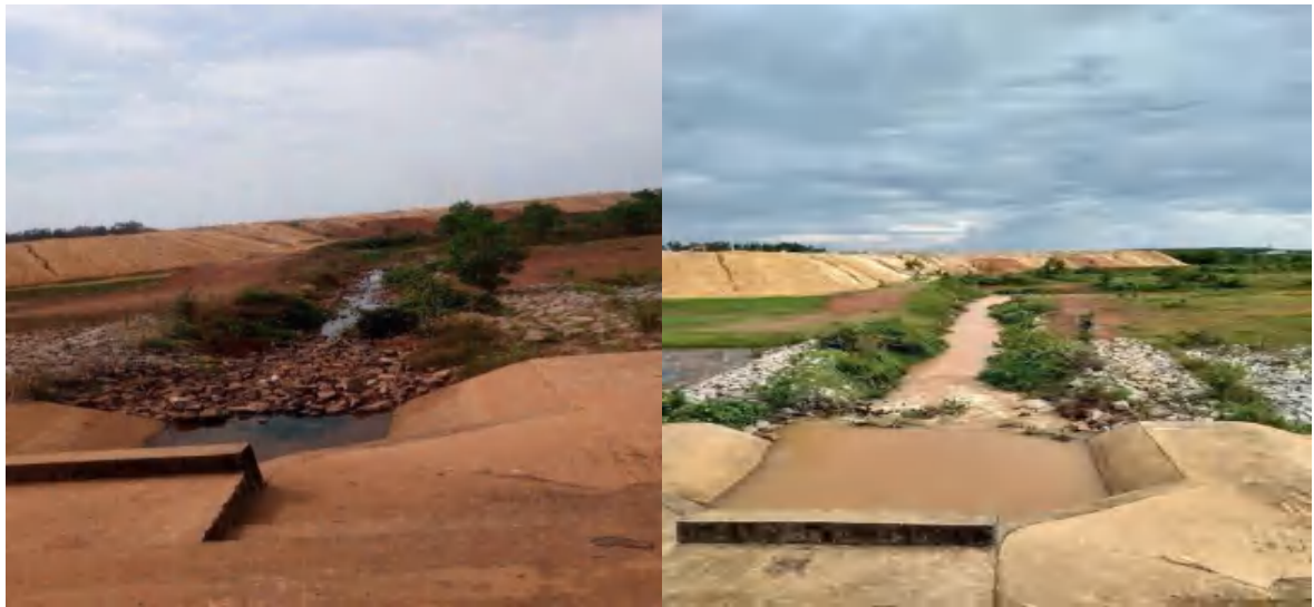
Hình 3.10. Nước bị chặn phía sau công điều chỉnh lưu lượng vào mùa khô (bên trái, tháng 04/2018) và được xả vào mùa mưa (bên phải, tháng 7/2017)
