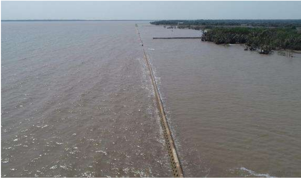
Hình 1-22. Đê giảm sóng kết cấu rỗng tại Tiền Giang
