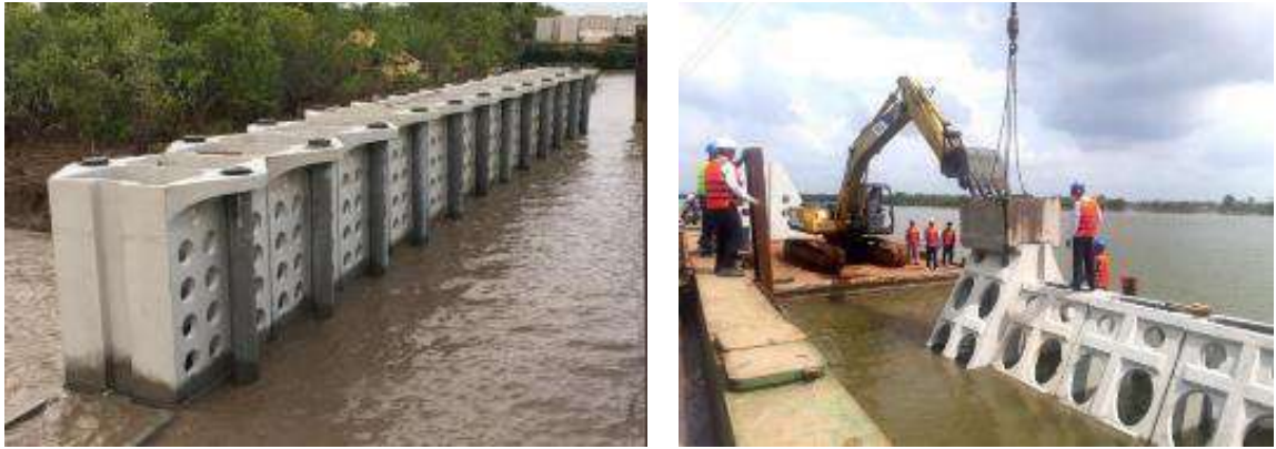
Hình 1-25. Kè BUSADCO được lắp đặt tại tỉnh Cà Mau
