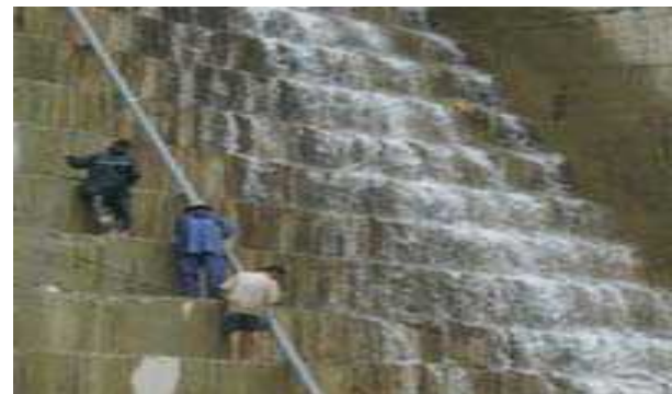
Hình 3(a,b). Hiện tượng thấm từ thượng lưu ra hạ lưu đập thủy điện Sông Tranh II
