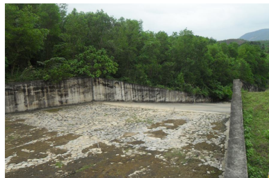
Hình 3. Hiện trạng tràn tháo lũ
