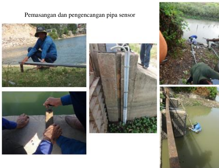
Gambar 1.11 Instalasi pelindung pipa dan sensor level air
