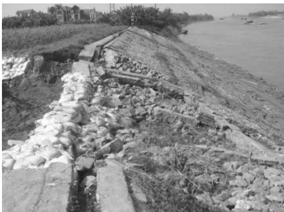
Hình 12: hỏng đỉnh kè và mái kè gia có bờ Gia Thượng (sông Đuống – Hà Nội).
