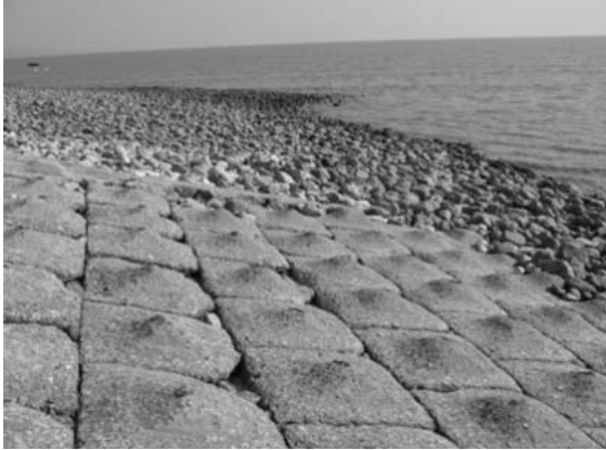
Hình 14: Hiện tượng ăn mòn rửa trôi và ăn mòn cơ học do sóng biển của bê tông kè biển Cát Hải (Hải Phòng).
