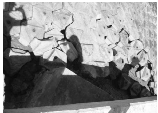
Hình 13: Tấm lát mái kè biển Nhà Mát (Bạc Liêu) bị bong tróc một đoạn phía cuối kè.
