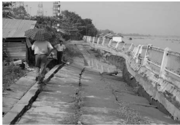
Hình 9: Tường kè đình Tân Hoa bị đổ, Mỹ Thuận - Tỉnh Vĩnh Long (2005).
