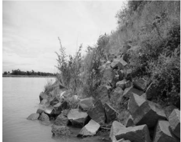
Hình 7: Kè Vân Ly – Quảng Nam hư hỏng chân kè.
