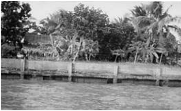
Hình 22: Tường Bê tông (sông Hậu - Cần Thơ) bị lún theo phương đứng.
