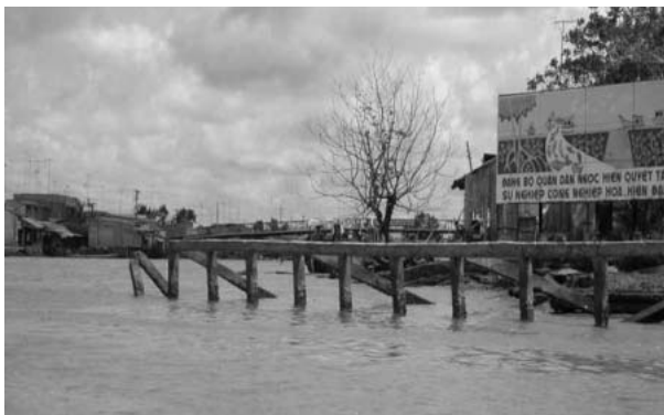
Hình 24: Tường Bê tông sông Cửa Lớn - Cà Mau) bị lún theo phương đứng.
