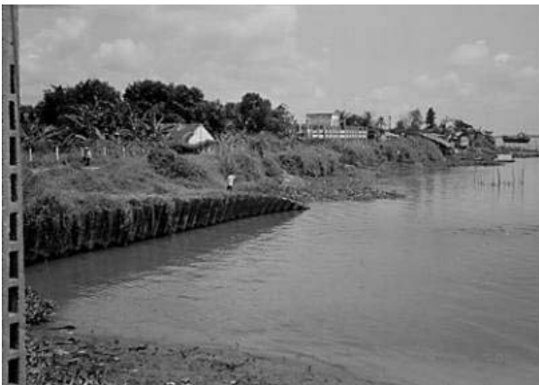
Hình 8: Cừ thép bị đổ do xói chân kè công trình kè cũ tại Sa Đéc - Đồng Tháp (1998).
