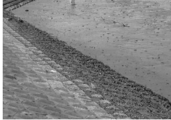
Hình 15: Tấm bê tông lát mái kè biển Nhà Mát (Bạc Liêu) bị sò biển bám kín.
