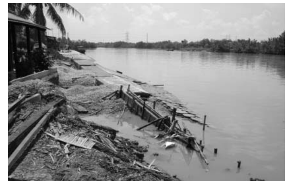
Hình 21: Kè khu vực cầu Bà Sáu, Rạch Tôm (huyện Nhà Bè - Tp.HCM) bị mất ổn định do thi công trên bờ trước khi thi công phần chân kè năm 2007.
