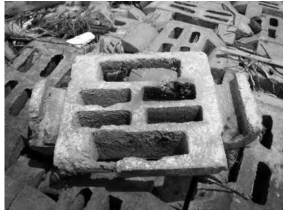
Hình 17: Tấm bê tông lát mái kè cảng Năm Căn (sông Cửa Lớn - Cà Mau) năm 2002.
