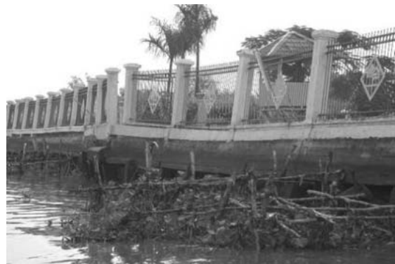
Hình 25: Kè khu vực bán đảo Thanh Đa (Tp.HCM) bị lún theo phương đứng.
