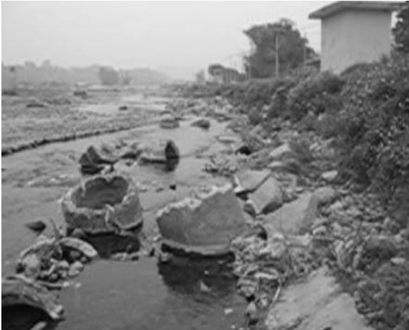
Hình 6: Kè suối Bắc Cạn hư hỏng chân kè.
