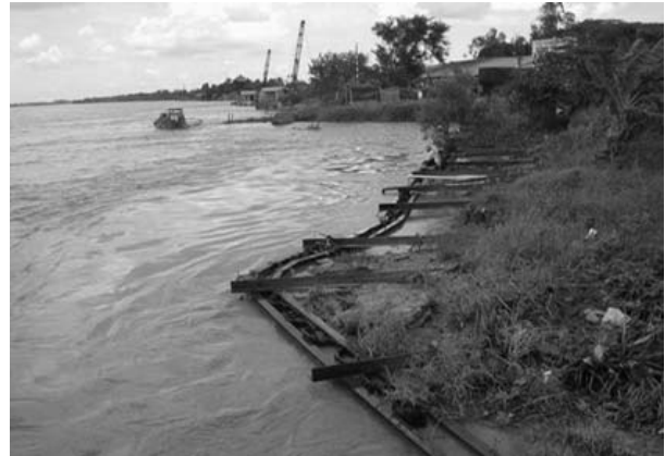
Hình 5: Công trình kè bờ khu vực bến phà Cần Thơ, tuyến chính trị chưa đạt.
