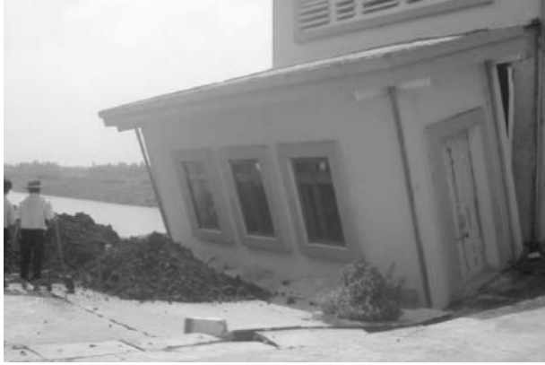
Hình 4. Sập gian điều hành cống Tác Giang do xói ngầm
