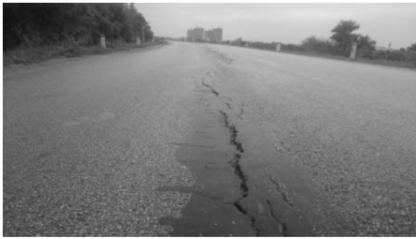
Hình 1. Sự cố lún, nứt mặt đê Tả Hồng đoạn từ Km 81+300 đến Km 81+970
